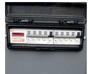
Schaltkasten mit Frequenz- überwachungsmodul
