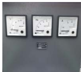
Analoge Instrumententafel mit Betriebsstundenzähler
