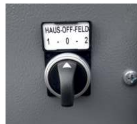
Umschalter Haus- Feldbetrieb
